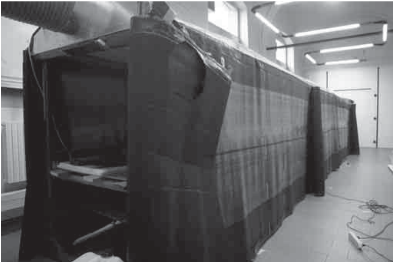
327 - Milano. Centro Trattamento Legno Bagnato. Il tunnel di essiccazione.
