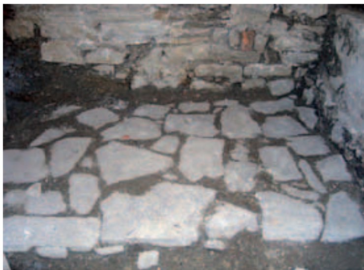
Fig.1: Stato di conservazione basolato (US 33 ante restauro1).
