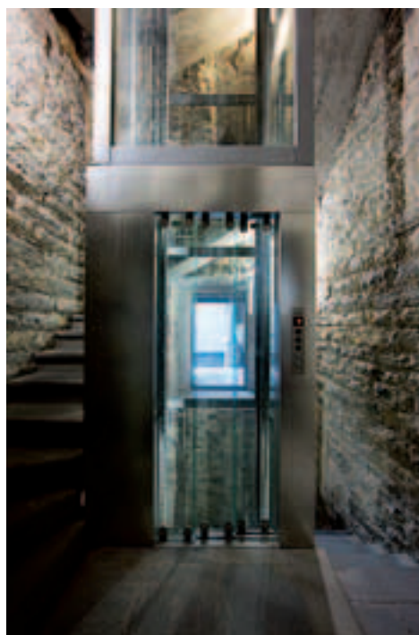
Fig.3: Ascensore: arrivo al primo livello del loggiato.
